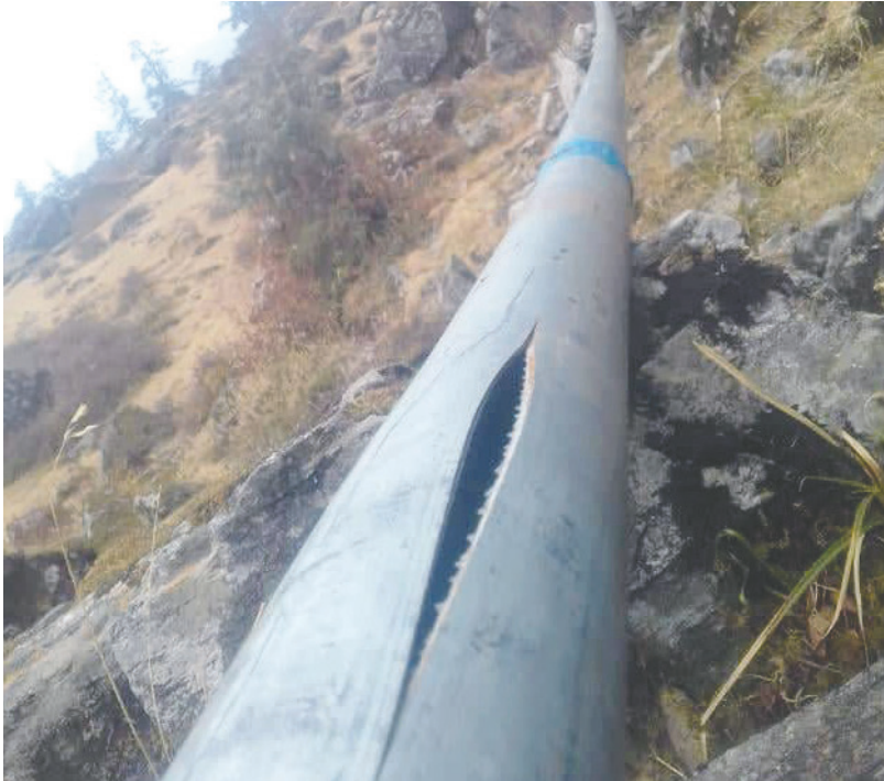
गुप्तीखा खानेपानी आयोजनाको फुटेको पाइप।
